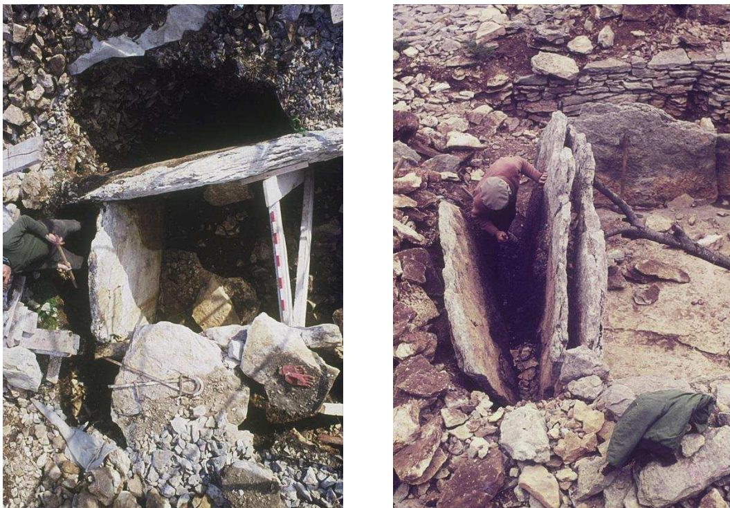
Figure 18 : à gauche, restauration du dolmen du Lamalou ; des excavations sont creusées dans le tumulus à l'arrière des dalles de la chambre pour être remplis de béton. A droite, un orthostate du dolmen de Ferrières en cours de restauration. L'écartement des litages de la dalle a certainement dû modifier le tumulus qui venait contre (photographies d'A. Colomer).
